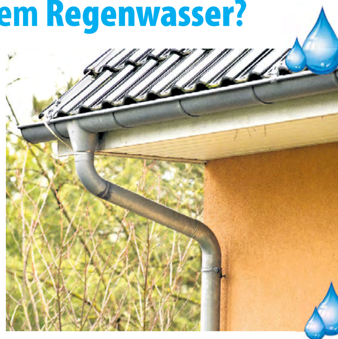
Wo führt diese Dachrinne hin? Auf keinen Fall in die Kanalisation!
